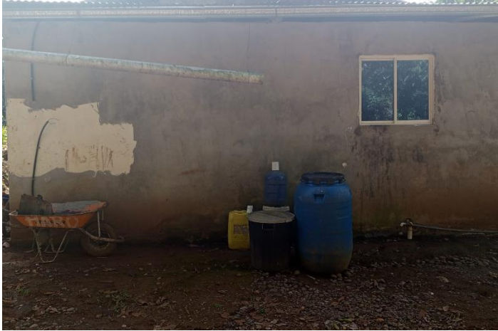
Fotografía 39. Almacenamiento de agua de lluvia contaminada
