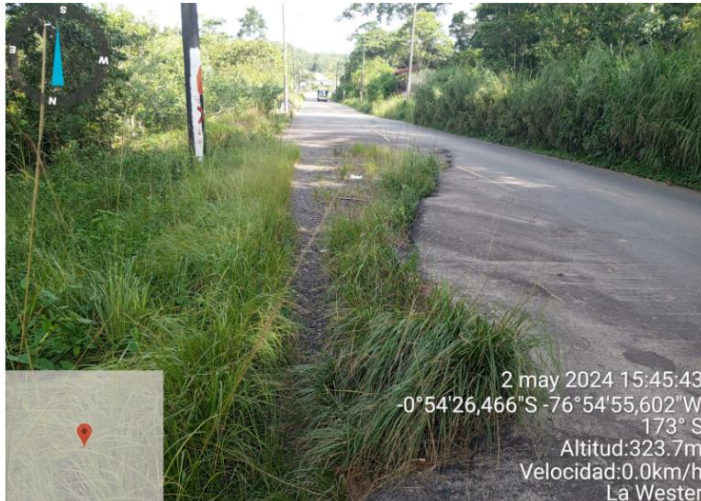
Fotografía 54. Interrupción de la vía por mal estado
