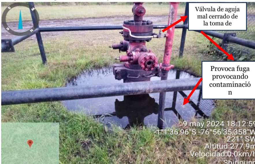
Fotografía 20. Pozo petrolero mal manejado
