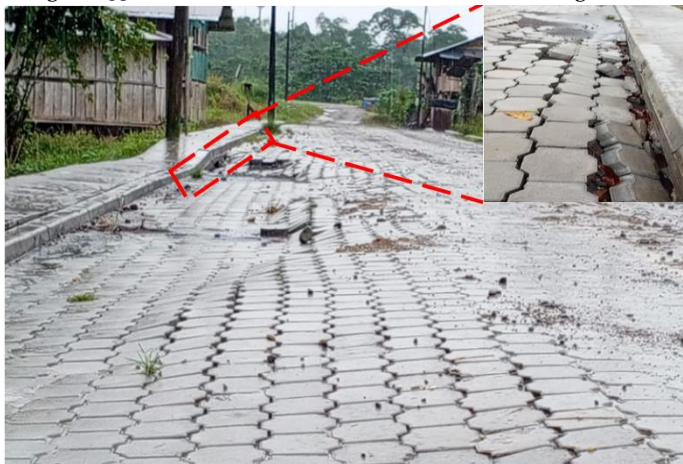
Fotografía 53. Calle Donato Arrobo ubicada en la zona de riesgo.
