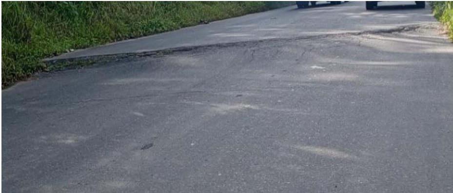
Fotografía 55. Falla geológica en la vía
