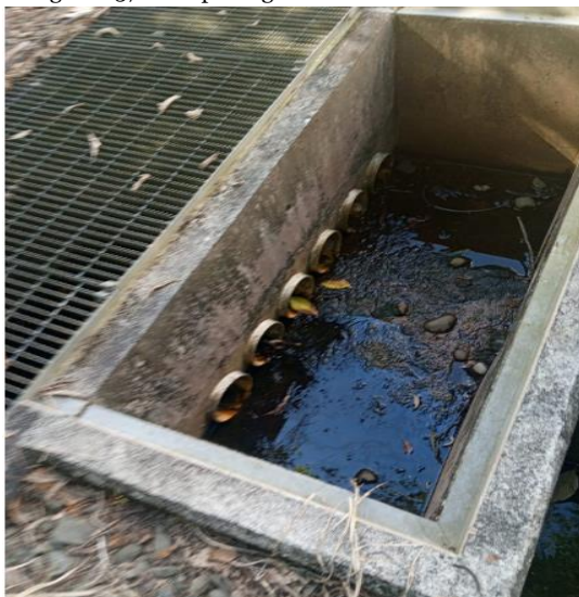
Fotografía 37. Trampa de grasa sin buen funcionamiento
