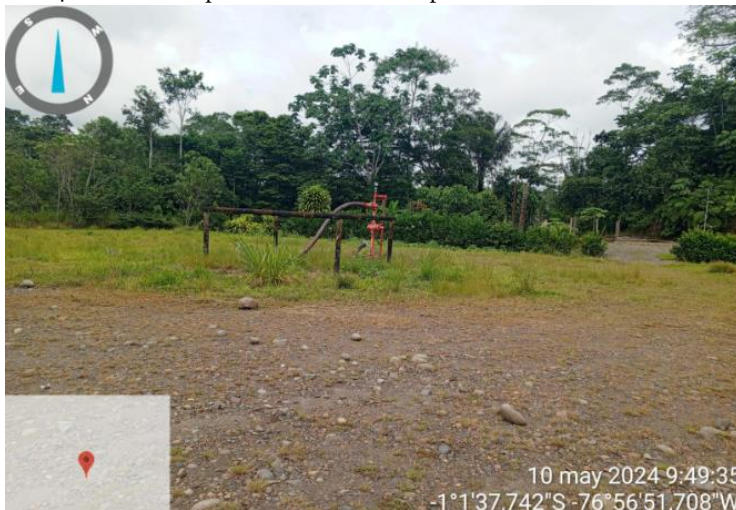
Foto 4. Pozo cerrado por derrame interno de pasivo ambientales
