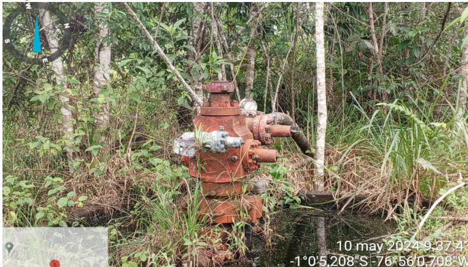
Fotografía 26. Pozo abandonado sin el correcto cierre
