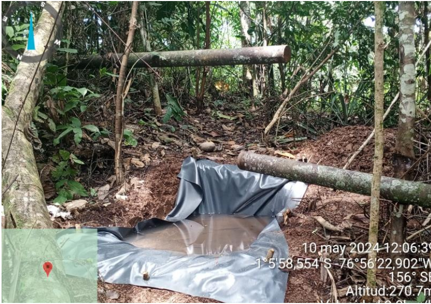
Fotografía 36. Rotura de tubería en el interior de la comunidad Cononaco
