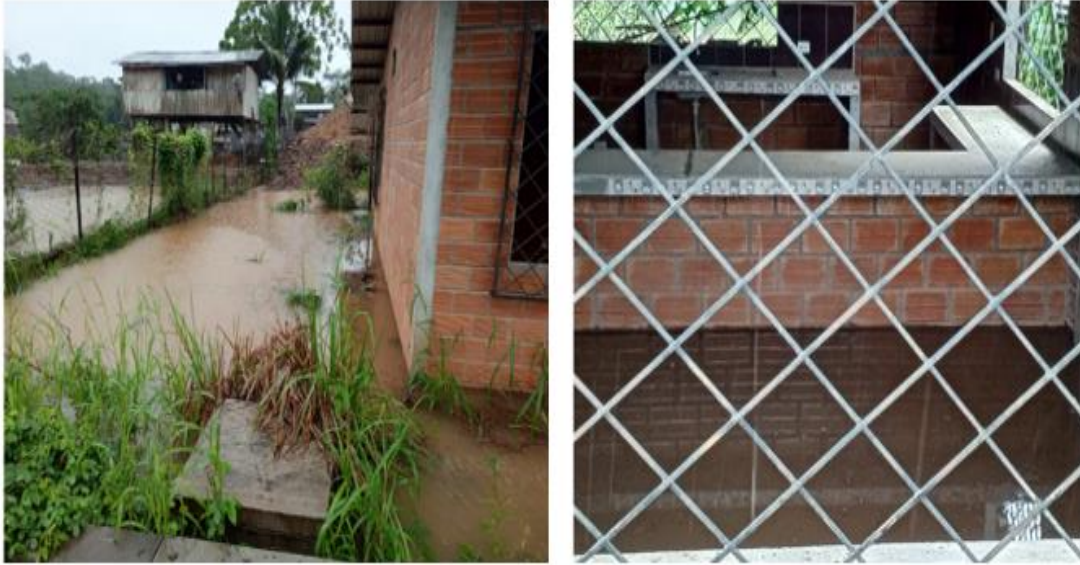
Gráfico 5. Inundación dentro de la vivienda por presencia de lluvias.
