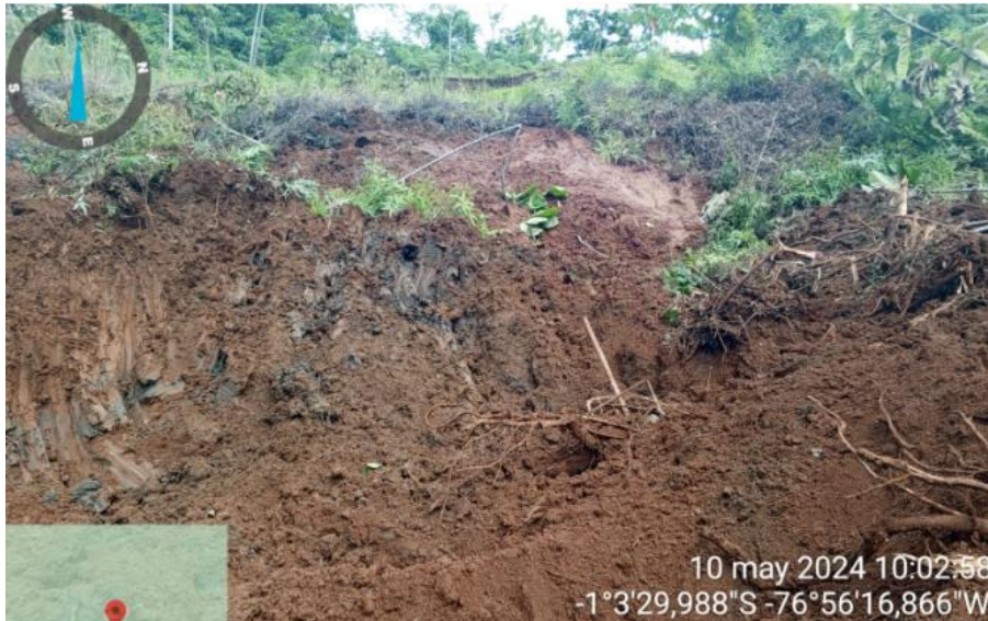
Fotografía 16. Deslizamiento de masa
